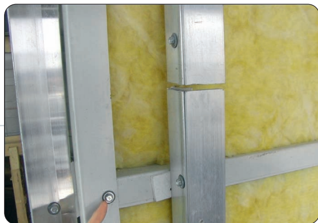
Bild 2: Eine derart ausgeführte Unterkonstruktion einer Fassade ist weder blitzstromtragfähig noch überhaupt stromtragfähig
