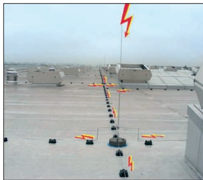
Bild 3: Wegen des vierfachen Anschlusses der Fangstange kommt es zur Blitzstromteilung auf einzelne Leitungen und damit zur Reduzierung des Koeffizienten k_c auf 0,25
