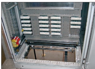
Bild 7: Doppelboden unter Rangierverteiler – Anschlussleitung für den Potentialausgleich ist kürzer als 50cm
