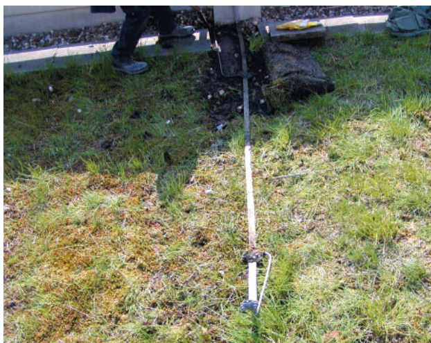
Bild 2. Stichprobengrabung auf Dach mit Gartenfläche zur Beurteilung der Korrosion bringt auch Ausführungsmängel zu Tage: Unzulässige Schleife um Trennstelle
