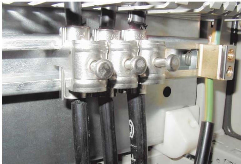
Bild 1: Schirmverbindungen sollten niederohmig und nach dem 360°-Prinzip ausgelegt sein
