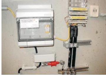
Bild 5: Das Kabelschirmende sollte indirekt über eine Funkenstrecke geerdet werden
