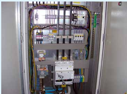
12 Der Monteur hatte wahrscheinlich keinen Seitenschneider und musste die Leitungsüberlänge im Rangierkanal „verstecken“
