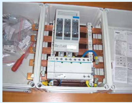
10 Neue Gehäuse für die Installation von Blitzstromableitern bei Gebäudeeintritt
