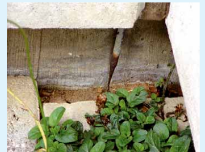
3 Durchgerostete Erdereinführung ohne Korrosionsschutz
