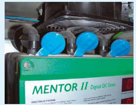
11 Sehr oft einzige, nicht fachgerechte Überspannungsschutzmaßnahme an Photovoltaikanlagen
