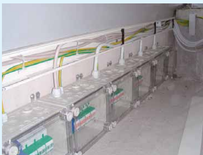
14 Nicht nur die Anschluss- und Erdungsleitungen sind zu lang und parallel geführt, auch die Potentialausgleichsschiene im Hintergrund war nicht geerdet!
