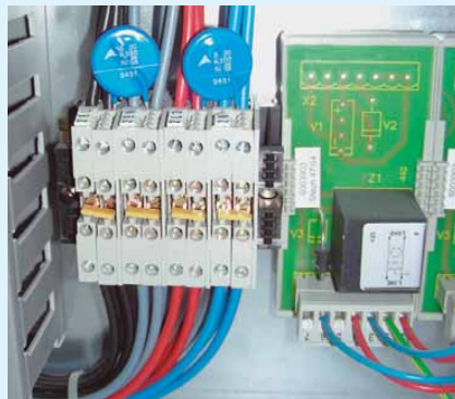
13 Es gibt Firmen, die auch auf diese Art und Weise Überspannungsschutzmaßnahmen ausführen, die jedoch nicht fachgerecht sind
