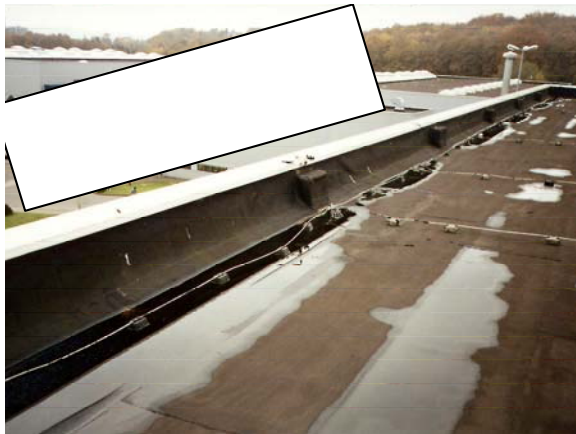
Bild 11 Die Fangeinrichtung ist nicht nur tiefer verlegt, sondern außerdem nicht mit den Ableitungen verbunden.
