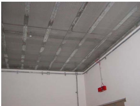
Bild 9: Nachträglich geschirmter Raum
