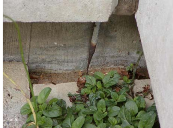
Bild 2 Durchgerostete Erdereinführung ohne Korrosionsschutz
