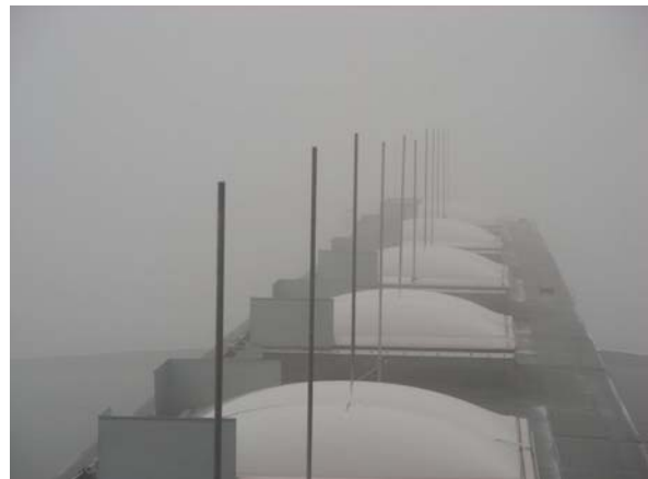
Bild 4: Zu viele Fangstangen an Dachfenstern
